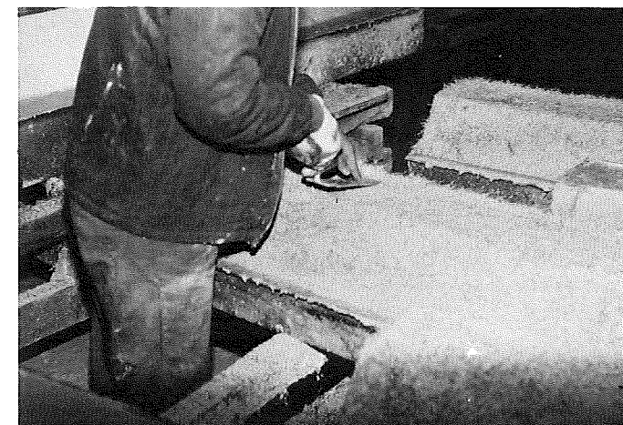
Figur 30. Indtrykning af glasfibre i betonen med murske.
